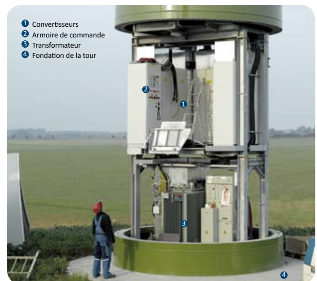
Composants électroniques dans le mât d'une éolienne
